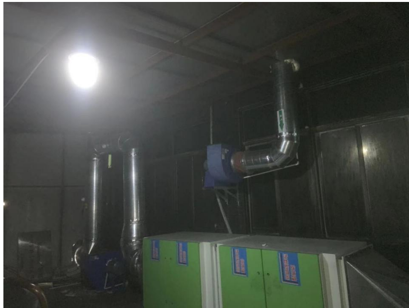
二楼两级活性炭处理装置
