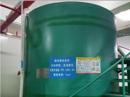
微电解反应罐
