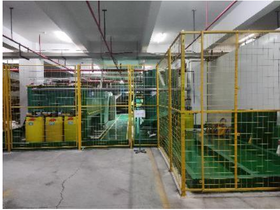
废水回用处理设施
