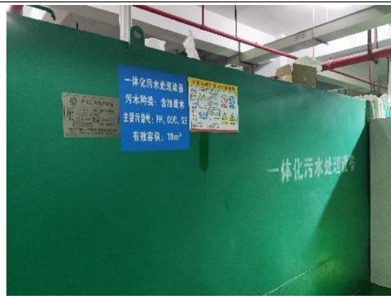
一体化处理设施
